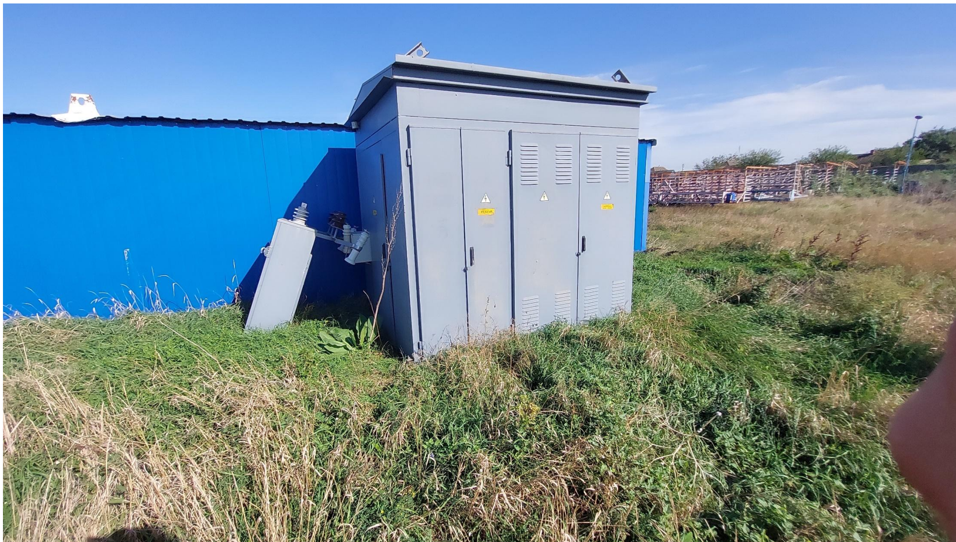
Фото 98. Шкаф электрической щитовой Ру-0,4 кВ
